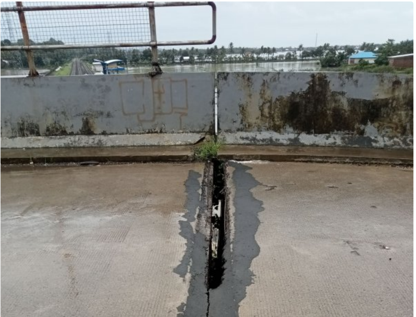
Sambungan jalan fly over Pekkae rusak parah
